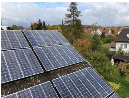
PV-Anlage von 1991! Immer noch in Betrieb!
